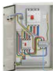
TỦ ĐIỆN CHỐNG SÉT
